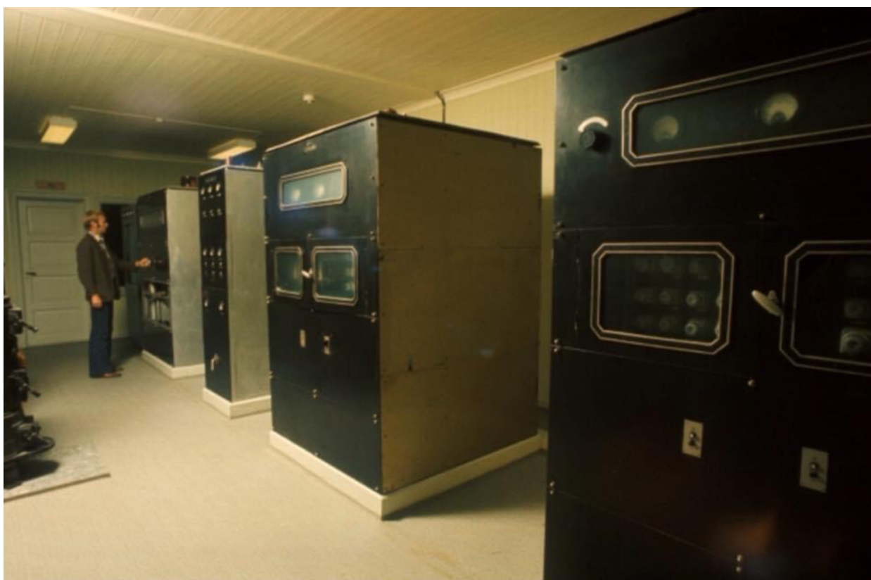
Bilde: LKP Porsgrunn Kringkaster med senderhallen på Borgeåsen. Western Electric sender på 1466 kHz i forgrunnen. (Bilde: Telemuséet.)
